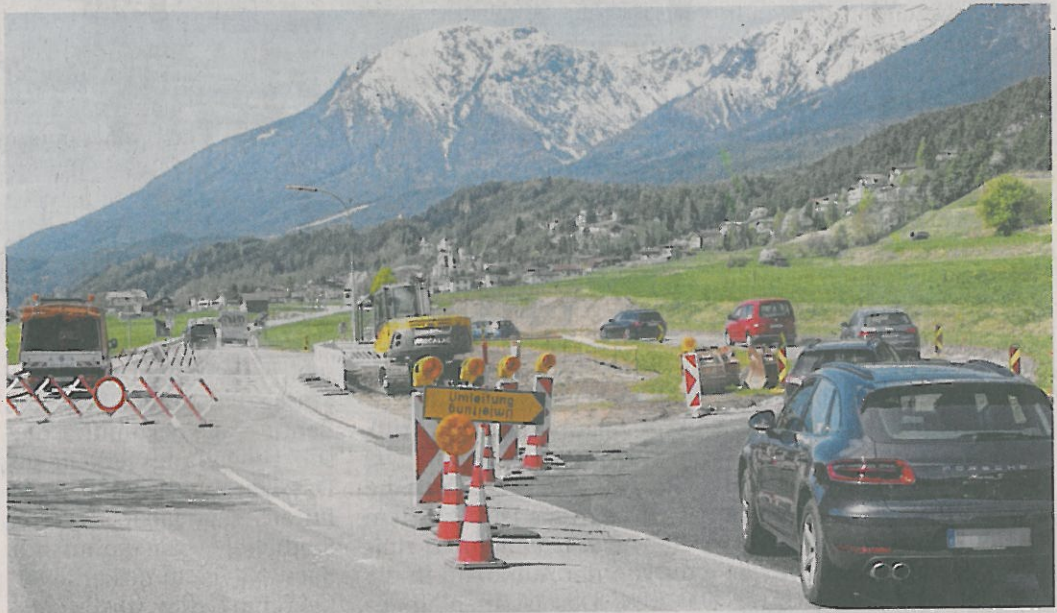
Am Mittwoch lief der Verkehr bereits probeweise über die kurze Ausweichstrecke. Ab kommenden Dienstag wird an der 21 Meter langen Unterführung unter der Bundesstraße bei Walchenbach gearbeitet. Foto: Daum
